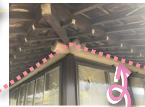
軒裏と垂木の間に この部分の隙間を塞いで 風や虫の侵入を防ぎます
